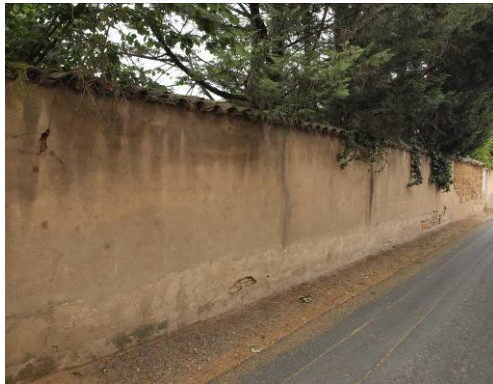
exemple de mur maçonné enduit et protégé par une couverture en tuiles creuses
