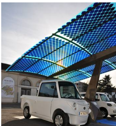
« ombrières » photovoltaïques sur un parking
