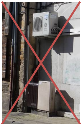
Appareils divers en applique sur la façade
