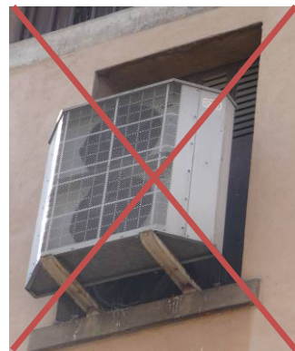
Les diverses installations techniques doivent être intégrées à l'architecture
