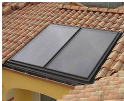
exemple de panneaux solaires thermiques
