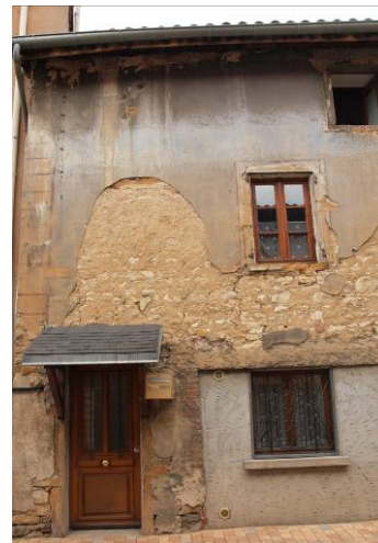
exemple de façade déstructurée
