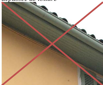
les dépassées de toitures lambrissées sont proscrites...
